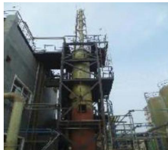
氯化塔应急吸收塔
