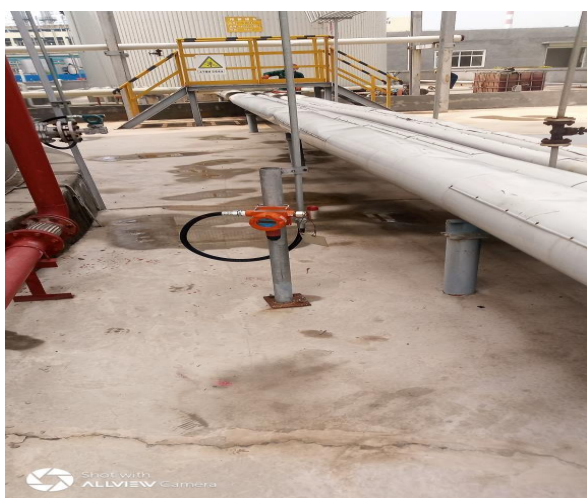
储罐罐区泄露检测装置
